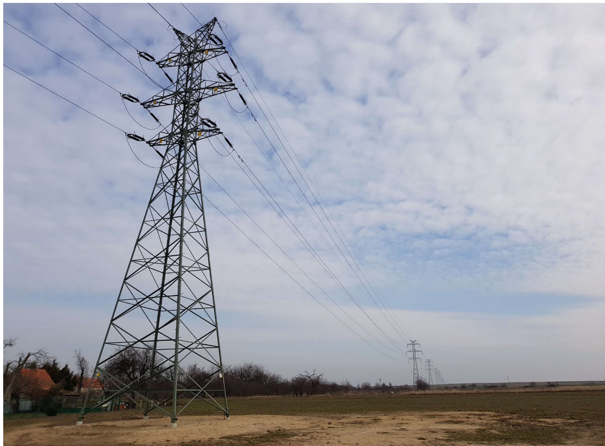
Tauron Dystrybucja, Linia 110 kV Przybków-Klecina
